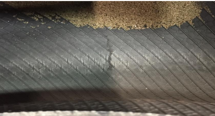
Resim1: Balans tozundan kaynaklanan astar çatlakları
